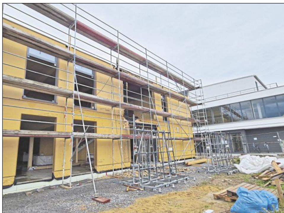
Der mittlere Bereich der Fassade des Begegnungszentrums ist vom Brand betroffen. Foto: Privat
